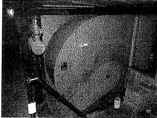
Exhaust fan overview
